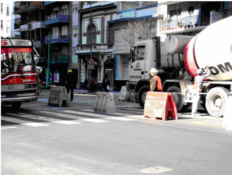
Obra situada en las coordenadas Fragata Presidente Sarmiento y Av. Rivadavia. Se verifica la inexistencia de señalización luminosa en los pontones que delimitan la obra en proceso ( foto 1 y 2)
